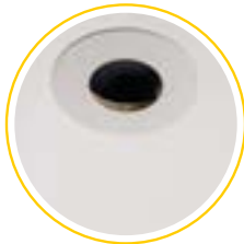
4. Bague de réduction installée. Découpe de plafond trop large entièrement recouverte.
